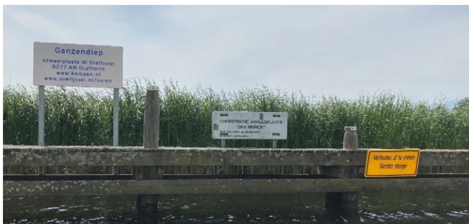
Een slechte steiger aan het Ganzendiep
